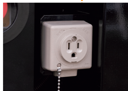
≫下部100Vインバーター電源取出口 OP 下部操作装置の横に100V電源取出口を設置
